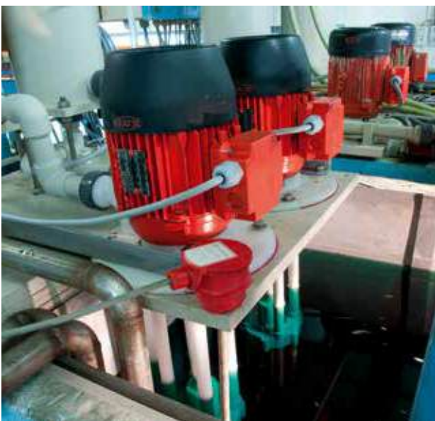
F 716 – Umwälzen von Chemikalien in einem Galvanikbecken.
