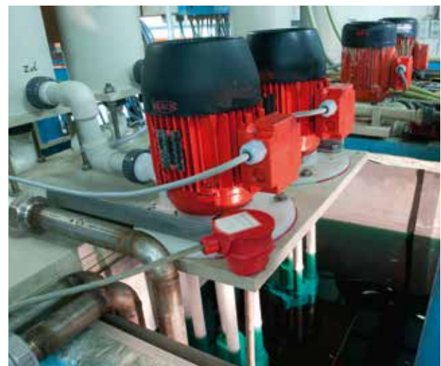
F 716 – Umwälzen von Chemikalien in einem Galvanikbecken.
