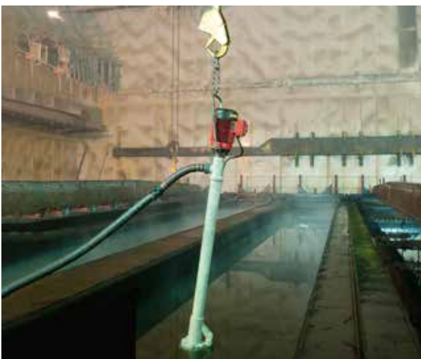
F 640 – Fördern verdünnter Salzsäure aus einem Beizbecken.
