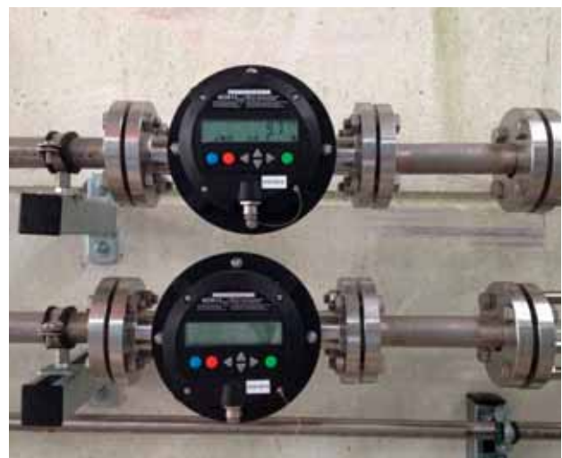
FMO 150 mit Flanschanschluss eingebaut in einer Rohrleitung.
