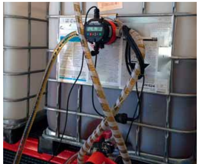
Halbautomatische Abfüllung mit FMC 100 und Schaltverstärker FSV 100 aus einem IBC.
